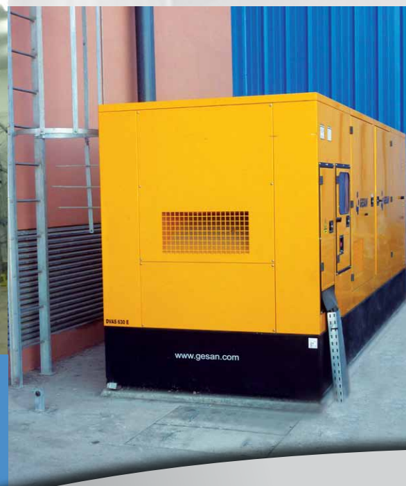
Groupe électrogène 630 KVA / Generator 630 KVA
