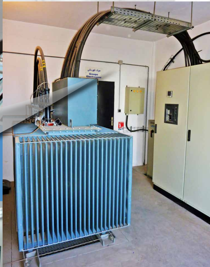
Poste de transformation, 1000 KVA / Post of transformation, 1000 KVA
