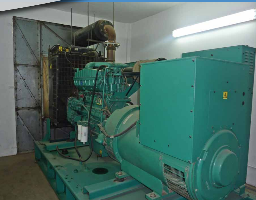
Groupe électrogène de secours 400 KVA / Emergency generator 400 KVA
