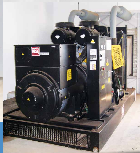
Groupe électrogène 800 KVA / Generator 800 KVA
